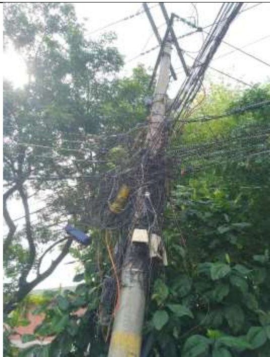
Poste da concessionária junto à unidade
