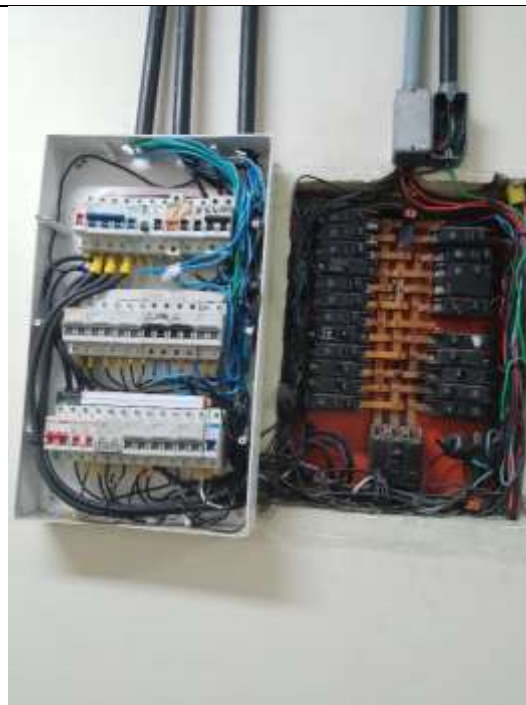
Quadro de distribuição atual
