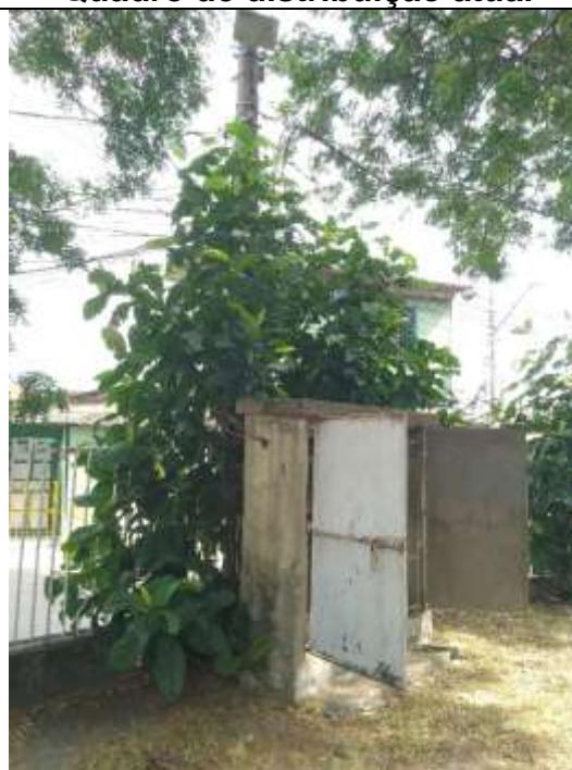
Abrigo do medidor
