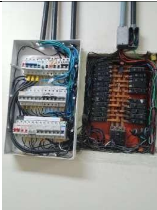
Quadro de distribuição atual
