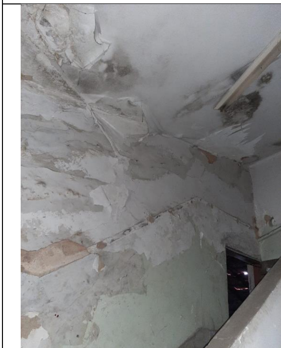
Parede do corredor prejudicada pela umidade
