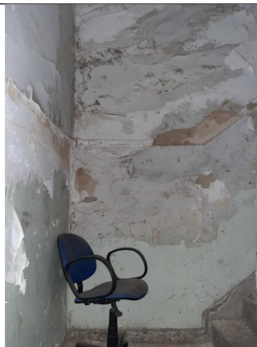
Parede comprometida pela umidade
