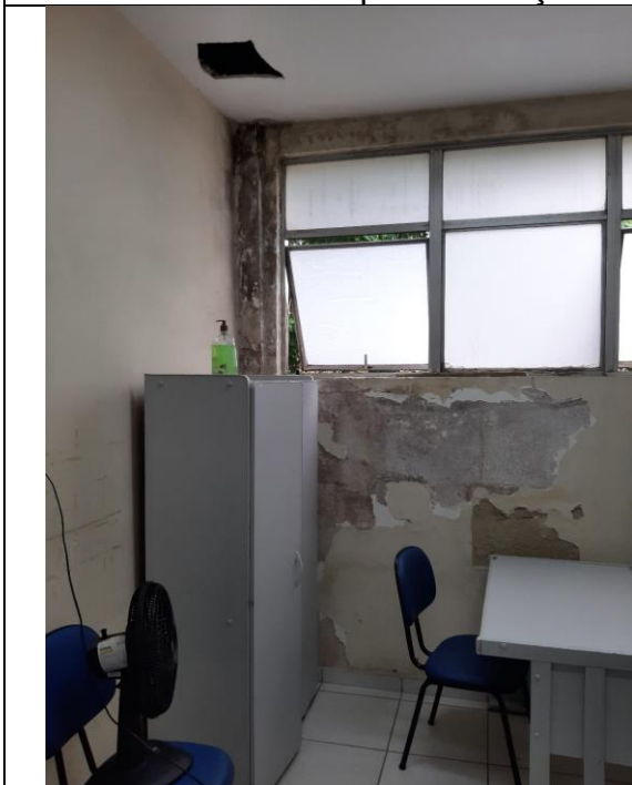
Paredes afetadas por infiltração
