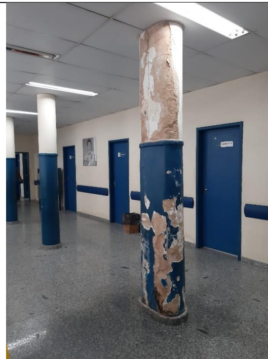
Pilar afetado pela infiltração
