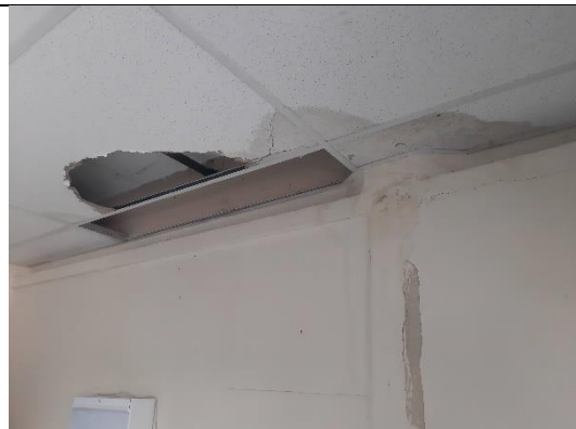
Forro comprometido pela umidade.
