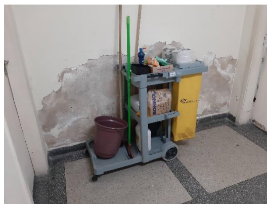
Paredes internas descascando
