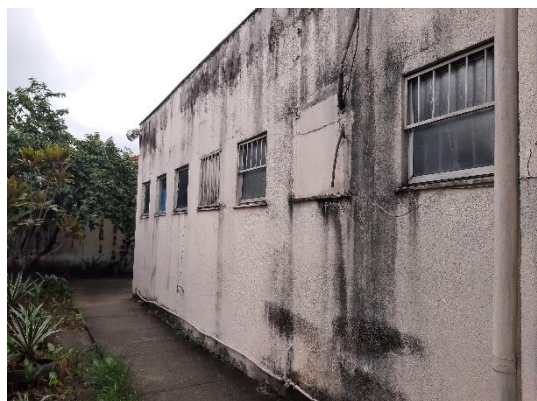
Paredes externas, manchas de umidade e escoamento d'água de chuva
