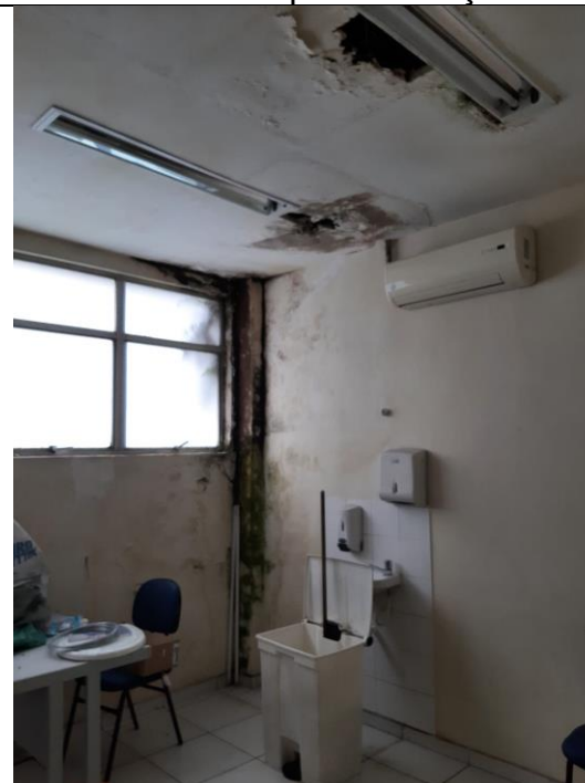
Paredes e teto afetados por infiltração
