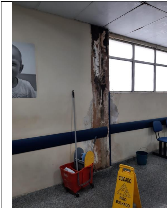
Parede afetadas pela infiltração
