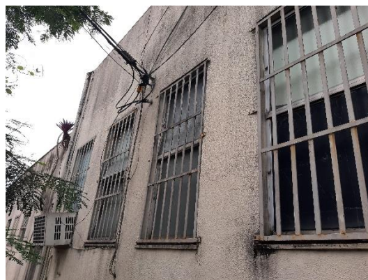
Paredes com mancha d'água
