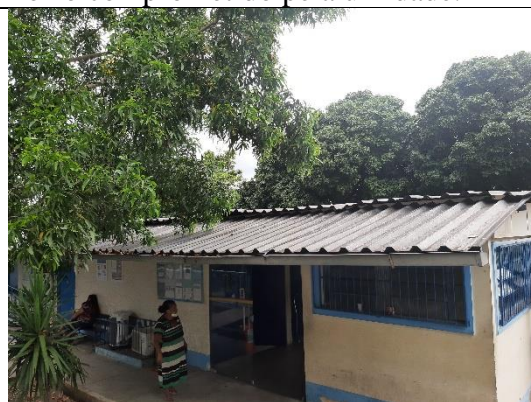
Telhado amassado e solto
