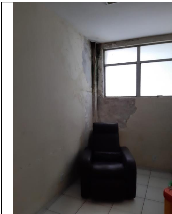
Parede afetada por infiltração
