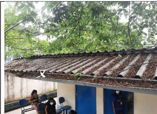
Calha e telhado sujos
